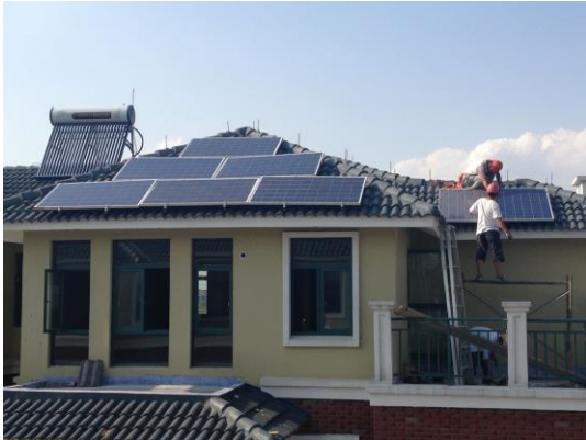
嘉兴新塍镇农户屋顶安装 Upsolar 光伏系统
